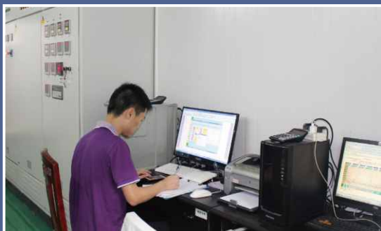
运行数据监测
