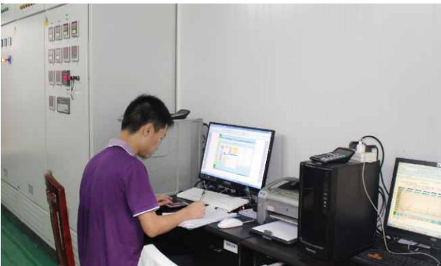
运行数据监测
